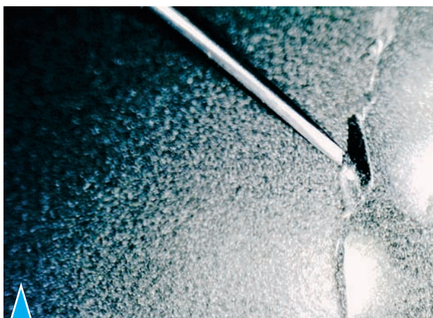
9.10.10. Отслаивание двух слоев лакокрасочного покрытия
